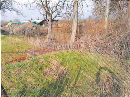
Foto 17: Grünschnittablagerungen im Bereich Durchlass 2
