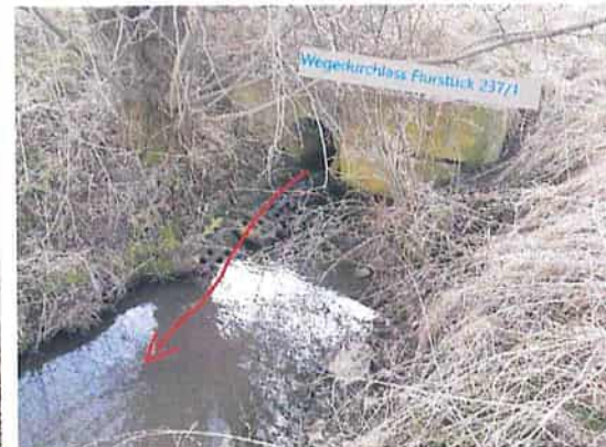
Foto 34: Auskolkungen unterhalb Wegedurchlass
